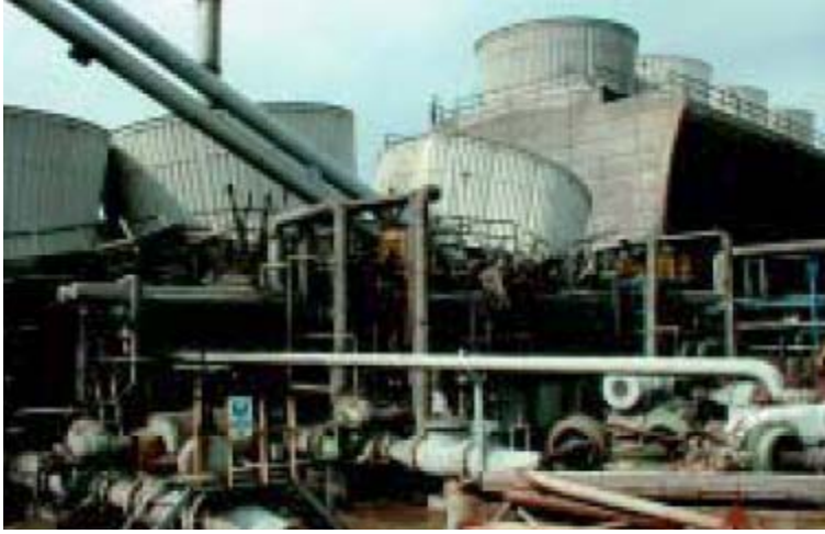
Şekil 11. Deprem Sonrası Soğutma Kulesi
