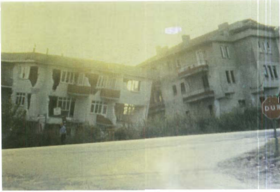
İzmit'güneydoğusunda sivilaşma nedeniyle yan yatmış yapılar
