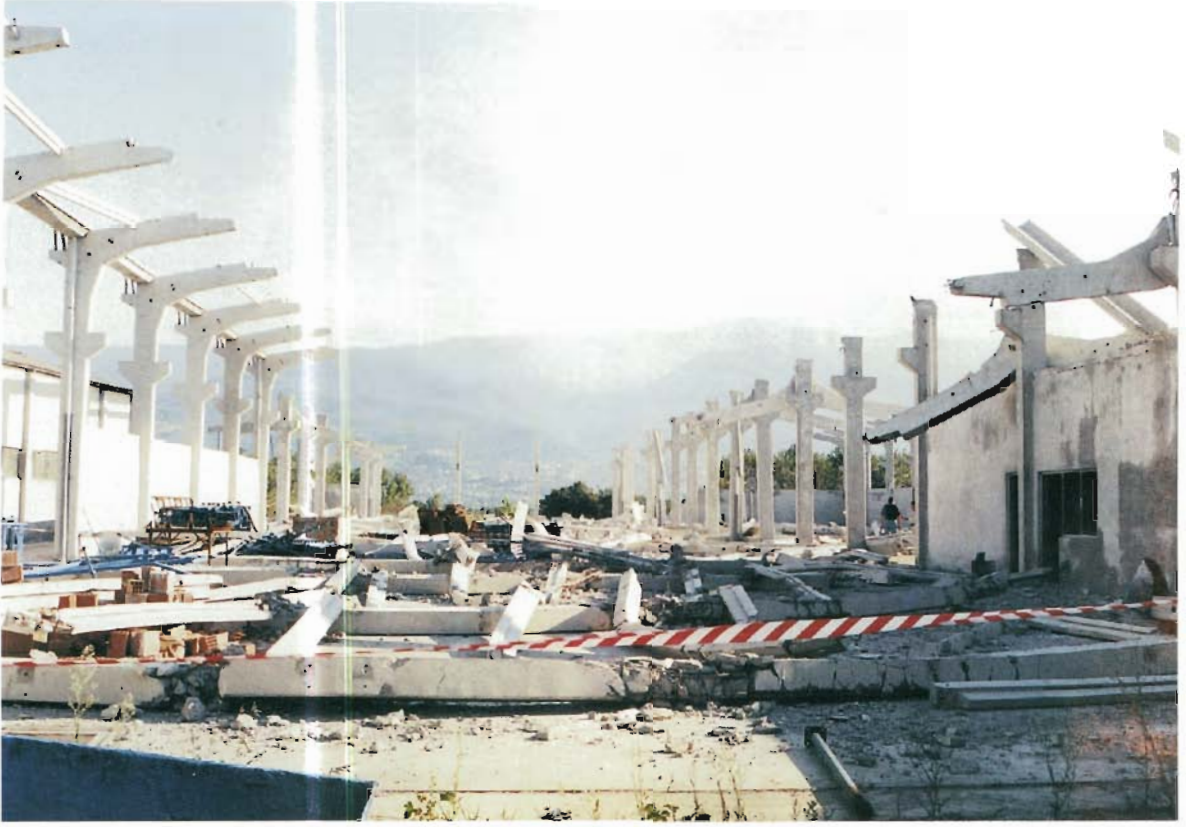
YIKILMIŞ BİR BAŞKA BETONARME PREFABRİKE KOLON-KİRİŞ UÇLARI MAFSAL BAĞLANTILI YAPI
