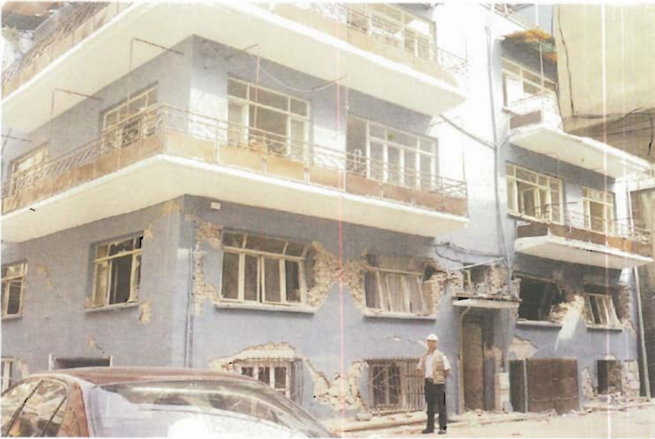
İZMİT'TE YÖNETMELİĞE AYKIRI OLARAK 2 KAT YERİNE 4.5 KAT YAPILMIŞ TUĞLA YIĞMA YAPI
