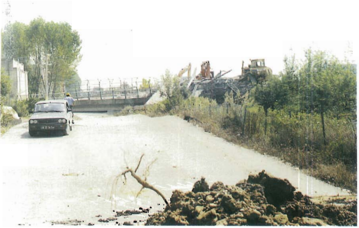
Faylanma ve farklı zemin oturmaları sonucunda çökmüş üst-geçit (Arifiye).
