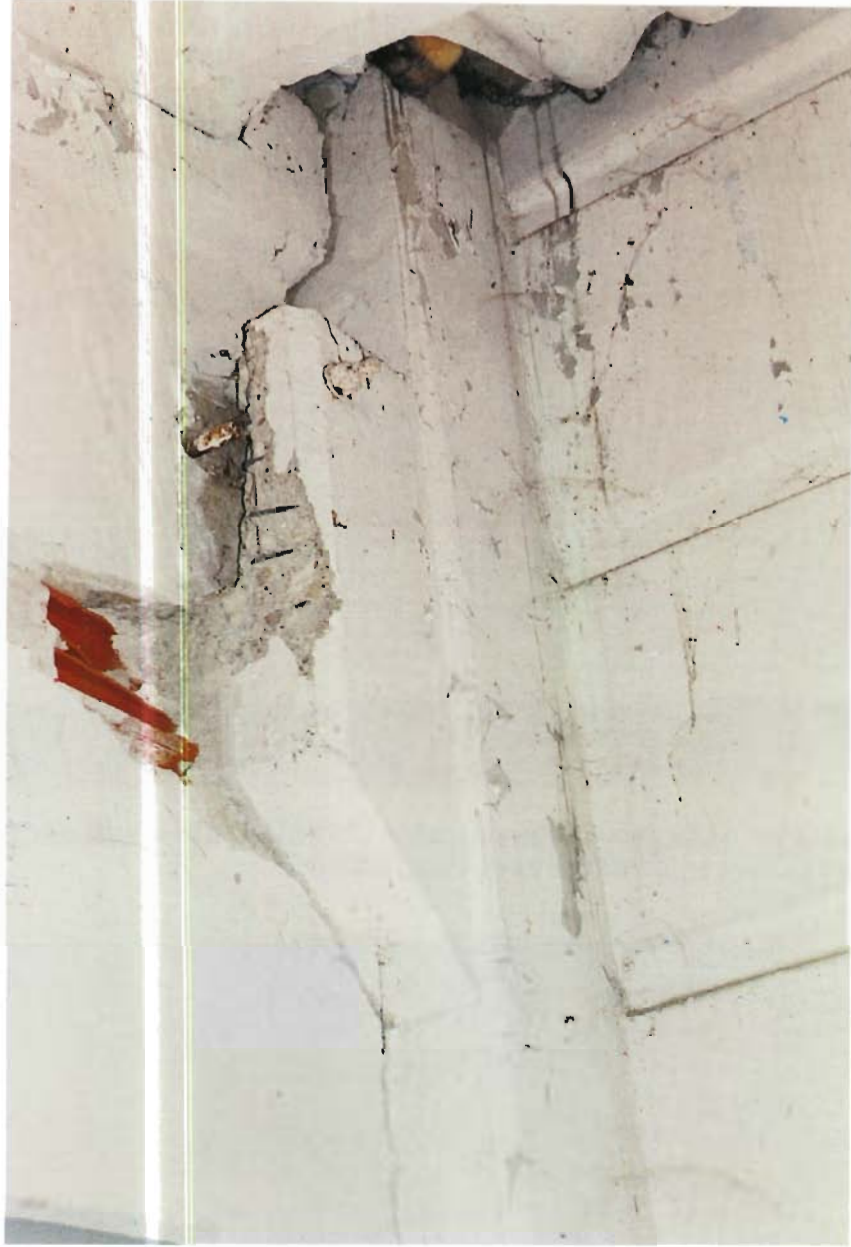
BETONARME PREFABRİKE KOLON KİRİŞ BİRLEŞİM YERİ HASARI
