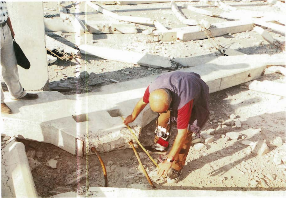
Y-BİÇİMİNDEKİ KİRİŞ MESNET ELEMANININ BULONLA BAĞLANDIĞI ANKRAJLAR KOLON BETONUNDAN SIYRILMIŞ
