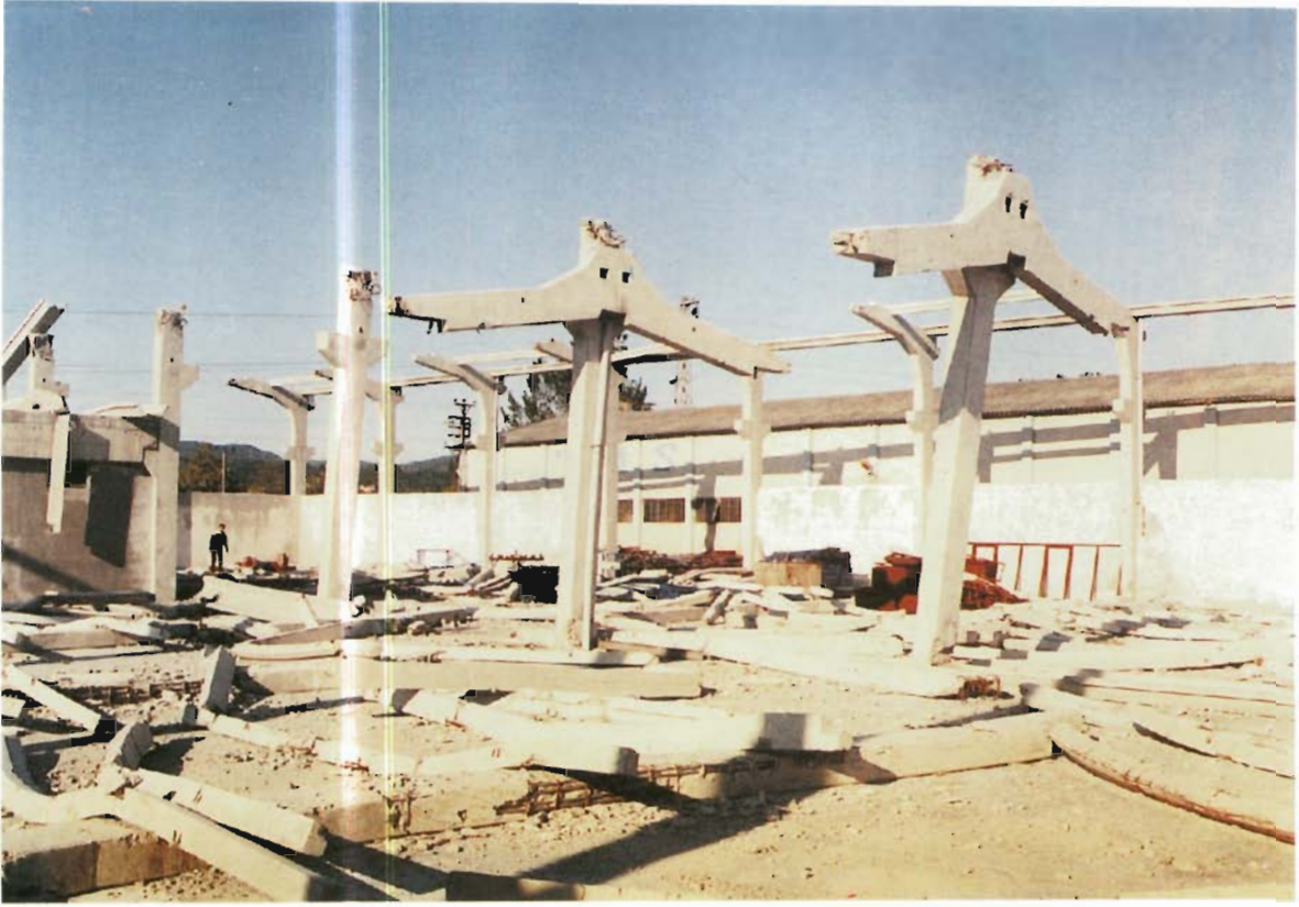
KİRİŞLERİ TÜMÜ İLE DÜŞMÜŞ MAFSALLI KOLON KİRİŞ VE KİRİŞ-KİRİŞ BAĞLANTISI OLAN YAPI
