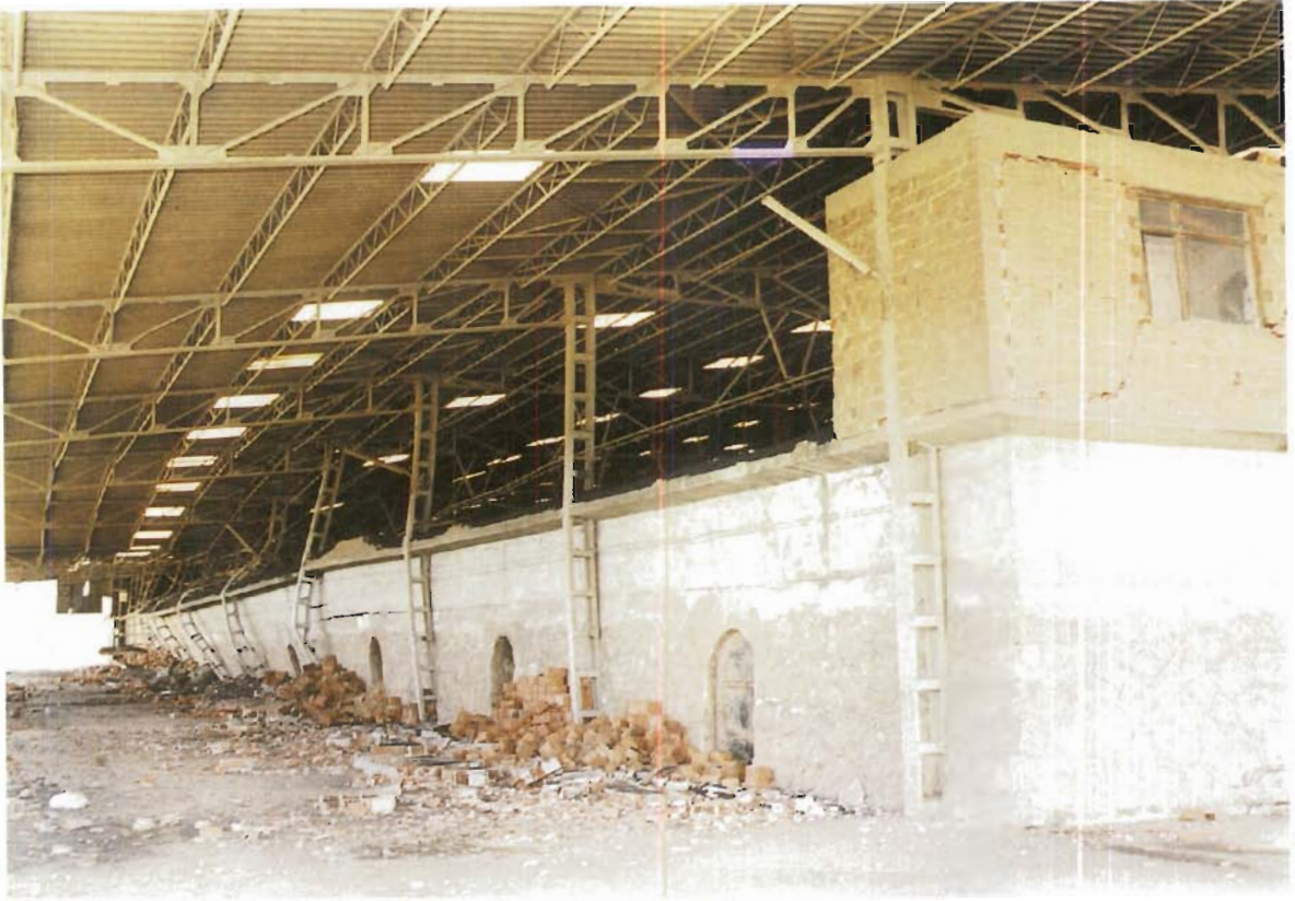
BOYSAN TUĞLA FABRİKASINDA FIRINLARIN YIKILMASI SONUCU HASAR GÖRMÜŞ ÇELİK KAFES KİRİŞ VE KOLONLAR
