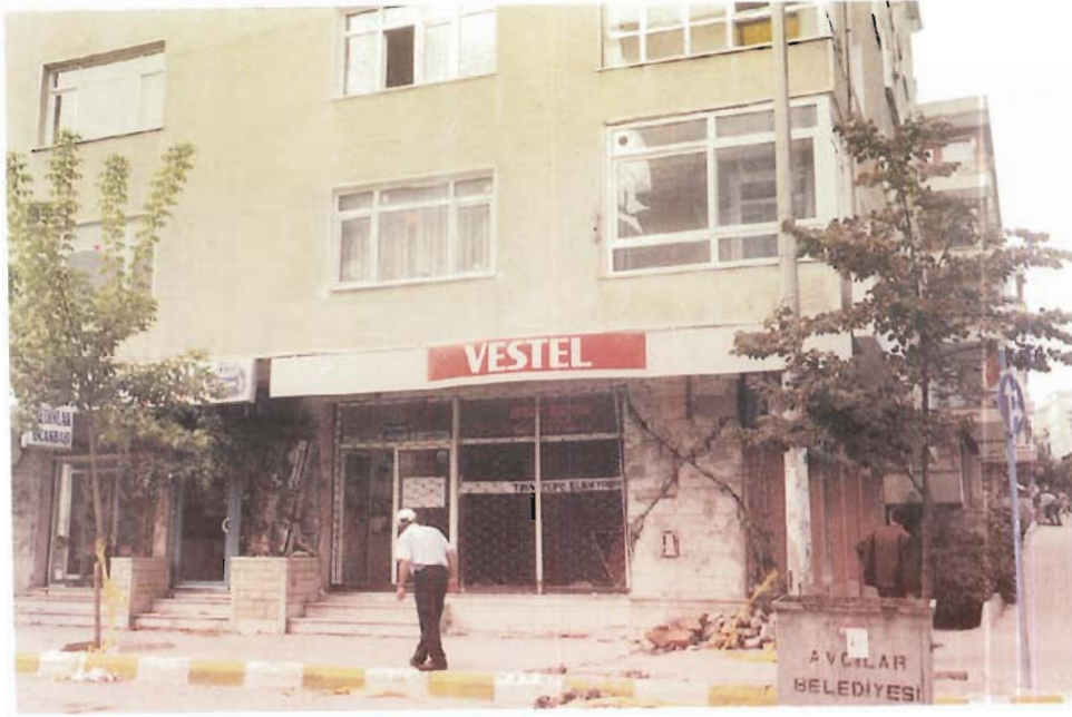
İSTANBUL AVCILARDA PERDE DUVAR DEMİRLERİ PASLANMIŐ VE KESME KIRILMASI OLMUŐ YAPI
