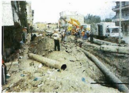
Foto-11 Su borularında hasar
