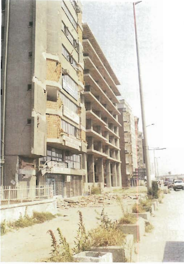
İZMİT'TE KONSOL ÇIKMAYA OTURAN DIŞ CEPHE SANDVIÇ DUVAR HASARI
