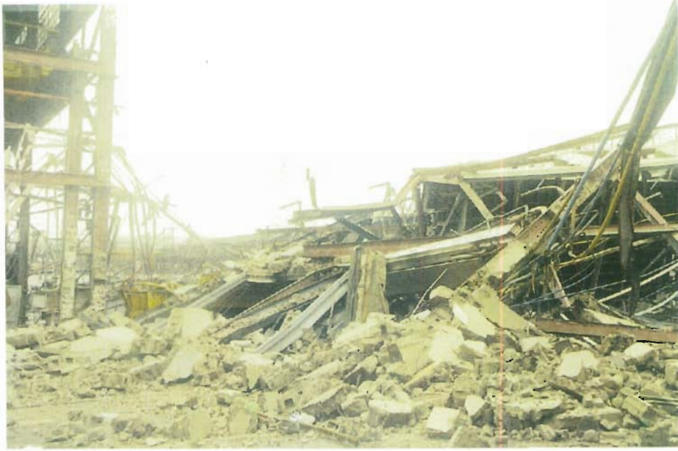
ENKAZ DURUMUNA GELMİŞ ÇELİK YAPI ADAPAZARI VAGON FABRİKASI
