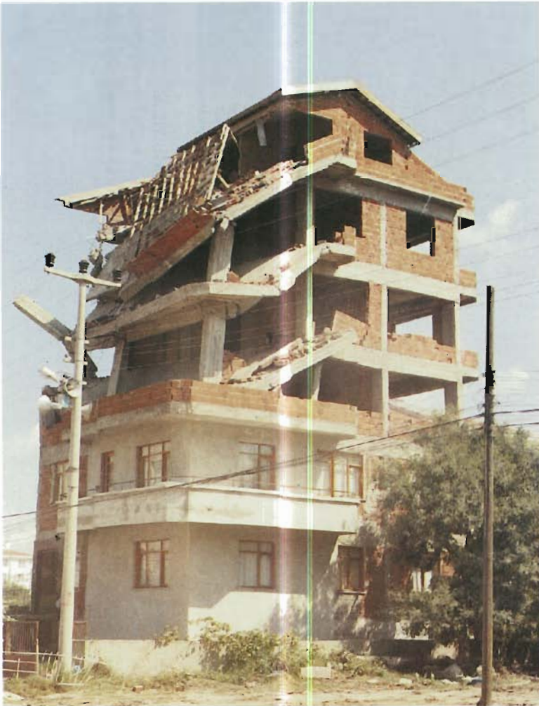
YALOVA'DA DAHA SONRA YAPILAN DÖRT KATLI ÜST BÖLÜMÜ ÇÖKMÜŞ BETONARME YAPI
