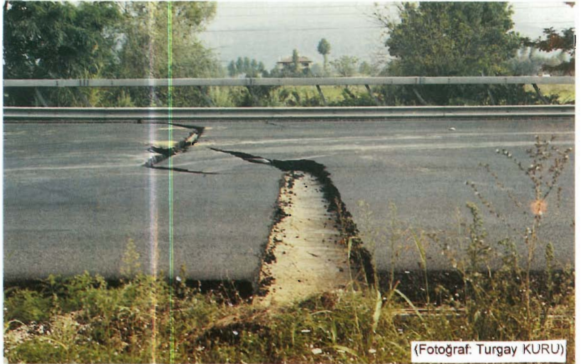
Arifiye üst-geçidi yakınlarında otoyolda farklı zemen oturmaları
