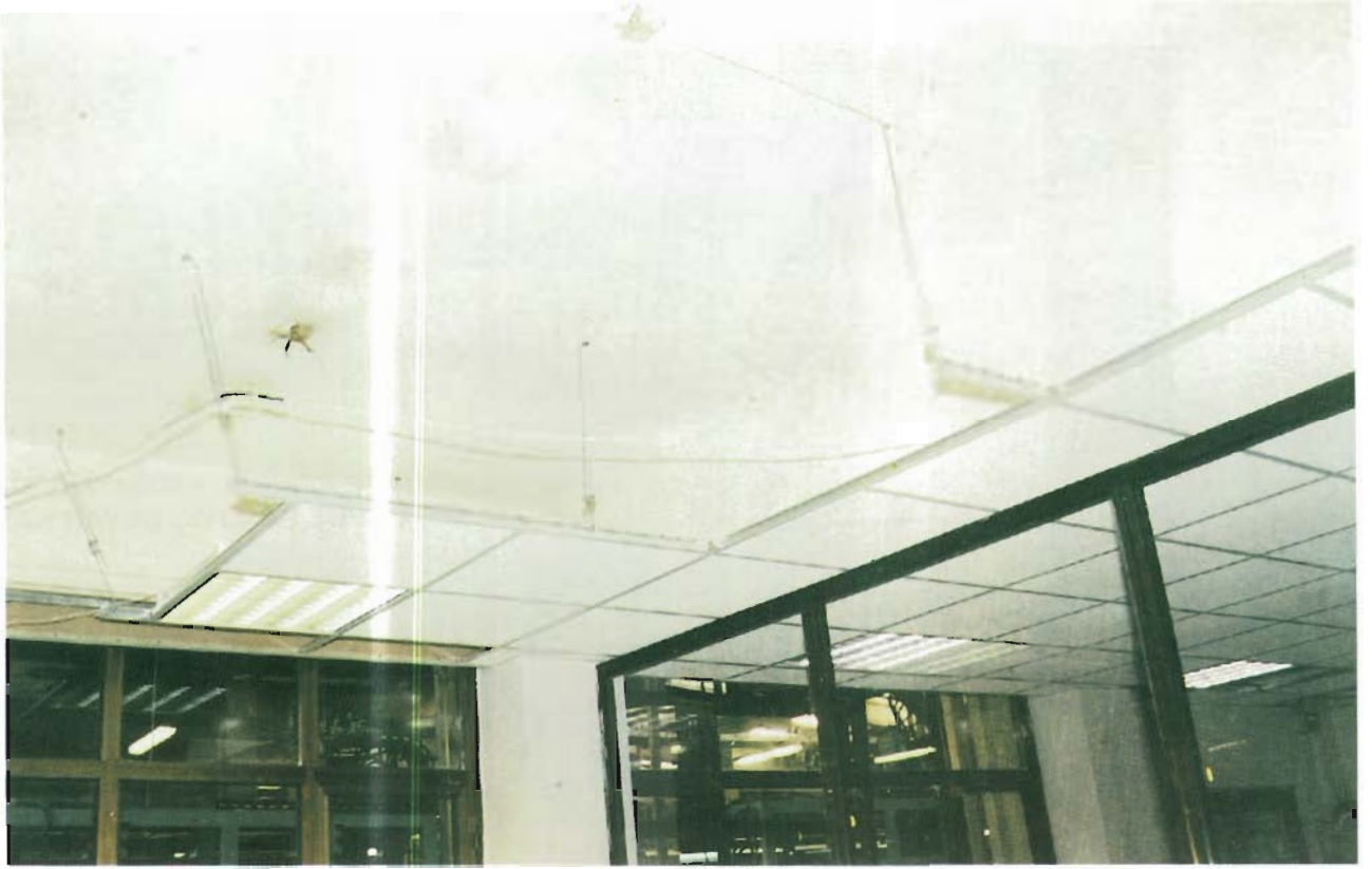
BETONARME DÖŞEMEYE ÇOK İNCE TELLERLE BAĞLI ASMA TAVAN HASARI
