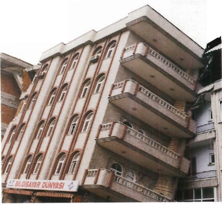
ADAPAZARI'NDA SIVILAŞMA NEDENİYLE TAŞIMA GÜCÜNÜ YİTİRMİŞ ZEMİNDE YATAN VE DEVRİLEN YAPILAR
