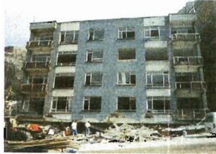
Foto-10 Yıkılmış bina
