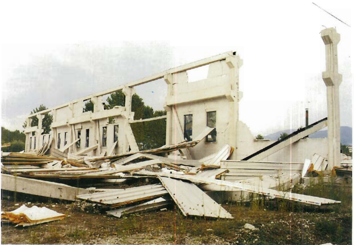
YIKILMIŞ BİR BAŞKA BETONARME PREFABRİKE YAPI
