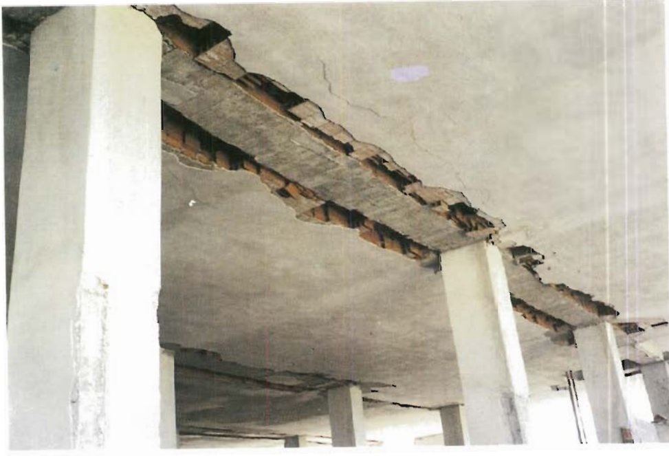
ASMOLEN DOLGULU DIŐLİ DÖŐEMELİ YAPIDA KOLONLARI BAĐLAYAN YASSI KİRİŐLERDE HASAR
