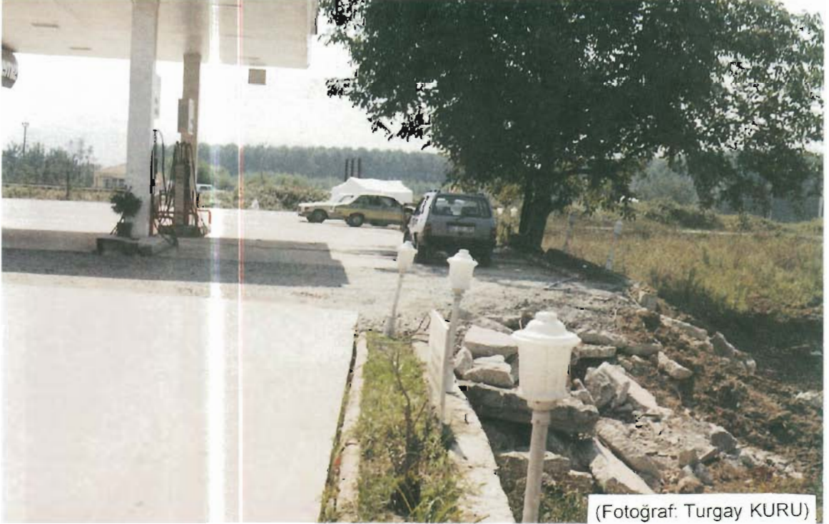
Arifiye doğusunda 4 m ötelenmiş benzin istasyonu duvarı. (Fotoğraf: Turgay KURU)
