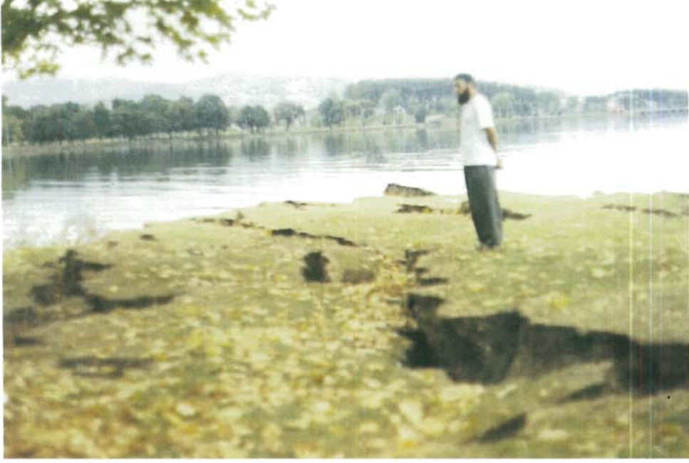
Başiskele'de (Gölcük) zemin yenilmeleri.
