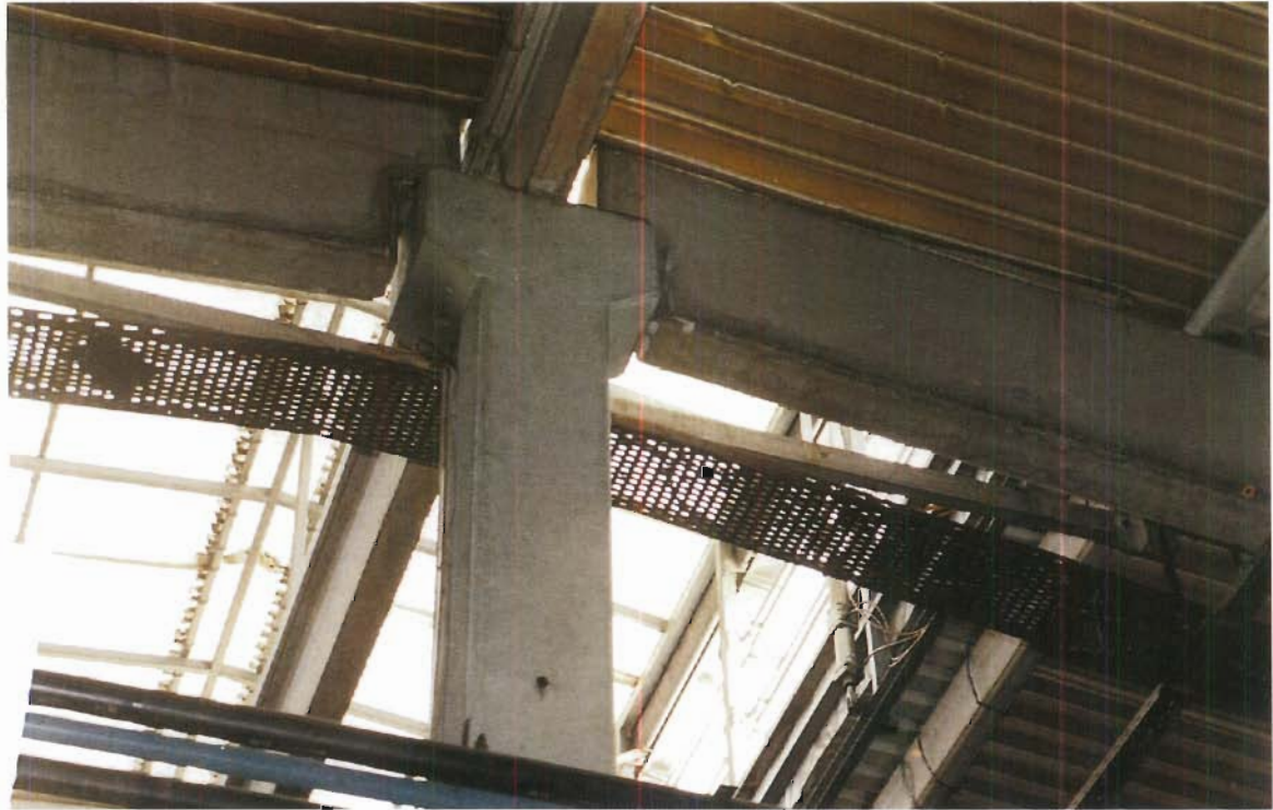
MESNETİNDEN KAYMIŞ BETONARME PREFABRİKE KİRİŞ
