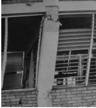
Fotoğraf 4. Tuğla Duvar Sebebiyle Kısa Kolon Kırılması
