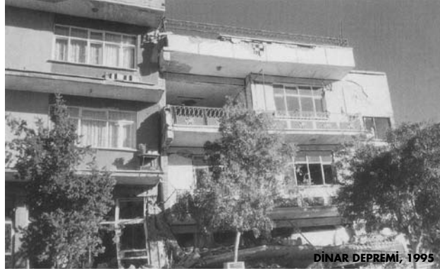
Fotoğraf 9. Farklı Kat Yükseklikleri Sebebiyle Çarpışma Etkisi Hasarı (Kaynak: Afet İşleri Genel Müdürlüğü Arşivi)
