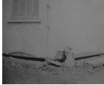
Fotoğraf 5. Zayıf Kolon Sebebiyle Çökme
